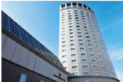
浦安ブライトンホテル外壁全面補修工事 (リニューアル工事)
